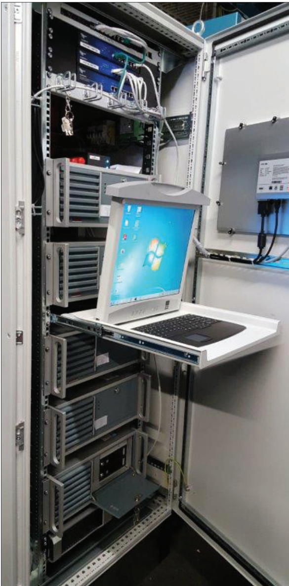
PC-basierte Steuerungen im neuen Schaltschrank ersetzen das bisherige PLS-System
