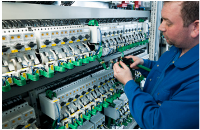
Für die Steuerung der Abluftanlage kamen insgesamt etwa 500 Eaton Motorstarter PKE mit SmartWire-DT Anschaltung zum Einsatz.
